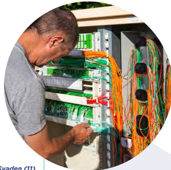
Syaden (11) Déploiement de la fibre optique dans le département
