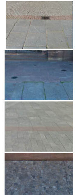
Les sols de la place de la Cathédrale et de la place du Château © B.FEDEL
