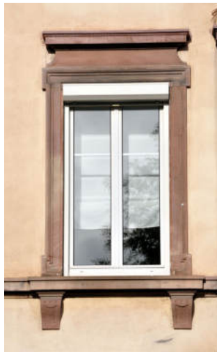
La pose de coffre de volets roulants sous le linteau, réduit la surface d'éclairage de la pièce. © Région Grand-Est - Inventaire général
