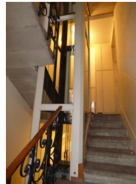
Installation d'ascenseur irréversible ayant conduit à la découpe du garde-corps et des marches, réduisant la largeur du passage de l'escalier. ©Atelier G. André
