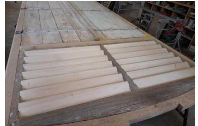
Volet en partie persienné en restauration - fin du XVIII e siècle © Atelier G. André
