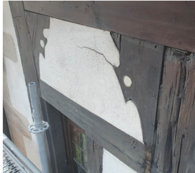
Fissuration de l'enduit hydraulique trop dur pour la structure en pan de bois © Atelier G. André
