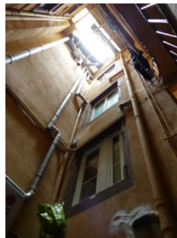
Les passages des réseaux et autres installations techniques dans les cours très enclavées, contribuent à réduire la qualité du cadre de vie ©Atelier G. André
