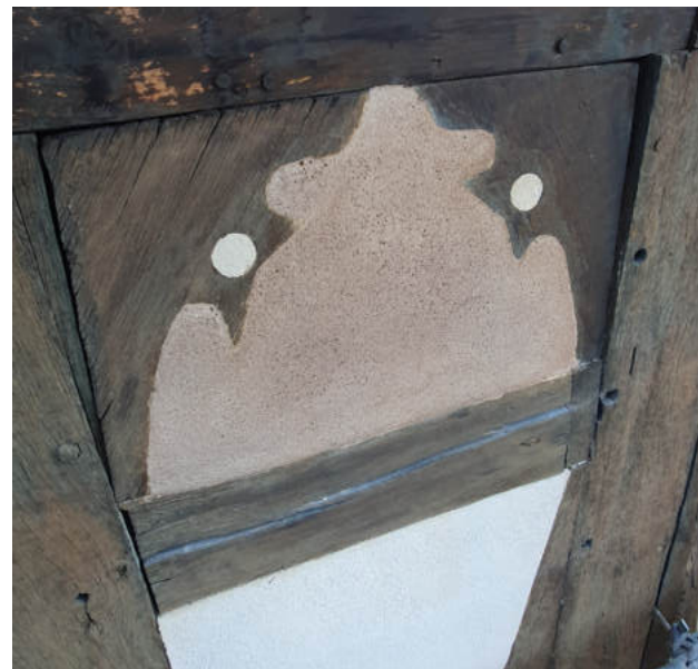
Echantillon d'enduit au mortier de chaux en remplacement de l'enduit hydraulique © Atelier G. André
