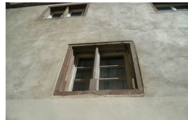
Restitution de trumeau de baies géminées médiévales dans une disposition fautive par rapport à celles d'origine et au schéma structurel. Le trumeau constitue un appui intermédiaire implanté dans l'axe médian du linteau pour en reprendre les forces © Bailly-Leblanc
