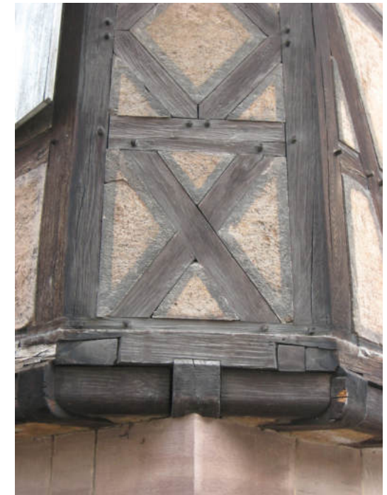
Enduit des remplissages au nu de la structure du pan de bois présentant des décors en filets © Bailly-Leblanc
