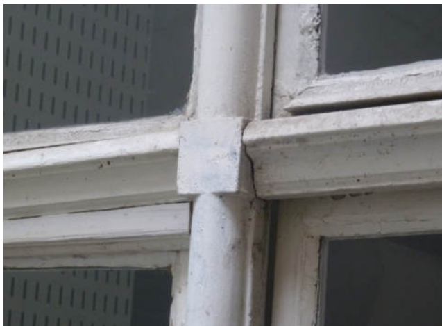
Détail d'une croisée de traverse du XVII e siècle dont le profil de traverse a pour but de protéger les ouvrants inférieurs des ruissellements d'eau de pluie © Bailly-Leblanc
